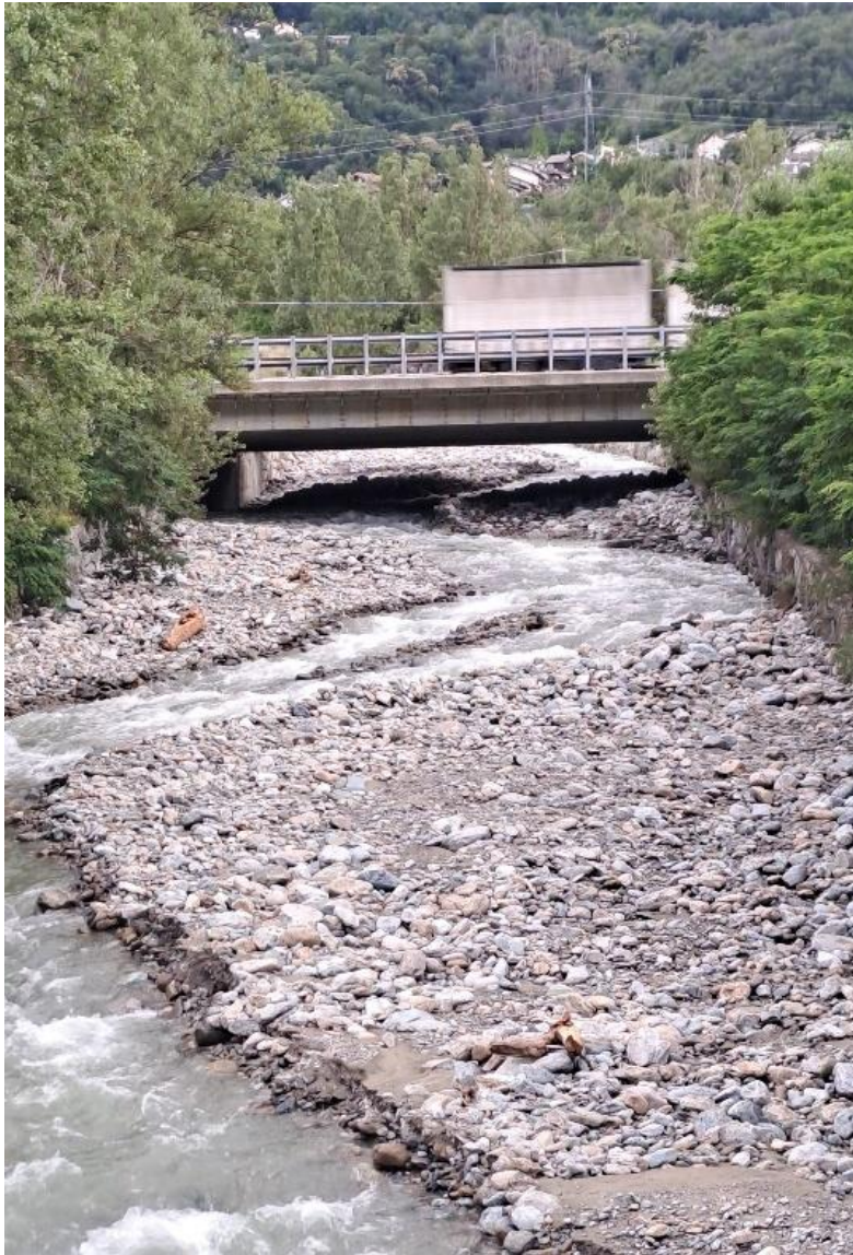
Notevole trasporto di materiale solido nell'alveo del T. Les Laures in corrispondenza del ponte autostradale (ID 3789).
