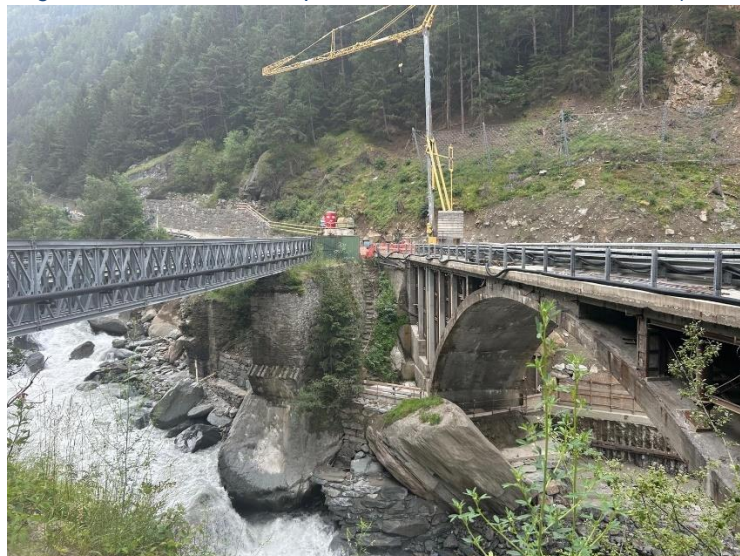
Fenomeni erosivi che hanno generato danni al Ponte della S.R. 47 in località Chevriil
