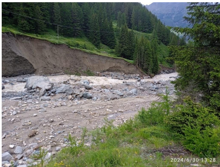
Profonda erosione nella sponda del T. Valnontey.
