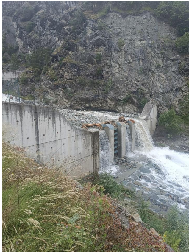
Briglie colmate dal trasporto solido del torrente Comboé a valle dell'abitato di Pollein. ID 3868 .
