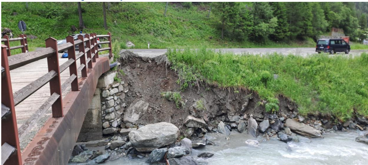
Fenomeno erosivo lungo spalla sinistra ponticello sul T.Evançon.
