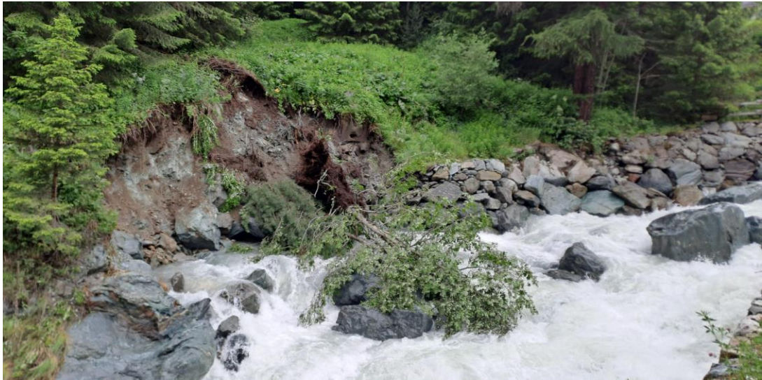
Fenomeni erosivi lungo il T.Evançon loc Frachey. ID 3729.
