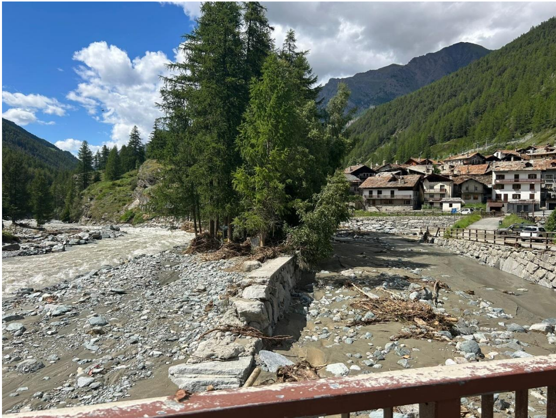
Confluenza tra il T. Grand-Eyvia e del T. Valnontey con cambio di percorso del T. Valnontey ed asportazione del ponte e della strada poderale in sinistra (ID 3875).
