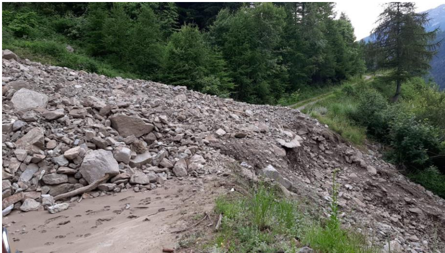
Strada Verdignolaz, colata detritica con erosione di parte della sede stradale e deposito di cordoni laterali nel comune di Valpelline (ID 3913).
