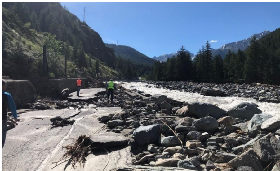
Dettaglio del tratto di strada asportato, visto da valle verso monte (ID 3852)
