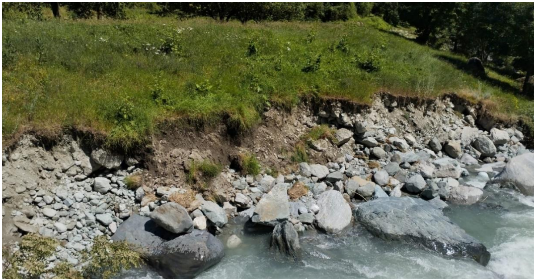
Erosione spondale T. Marmore ponte da Brusoncles a S.R. 46 loc. Champlong (ID 3950)
