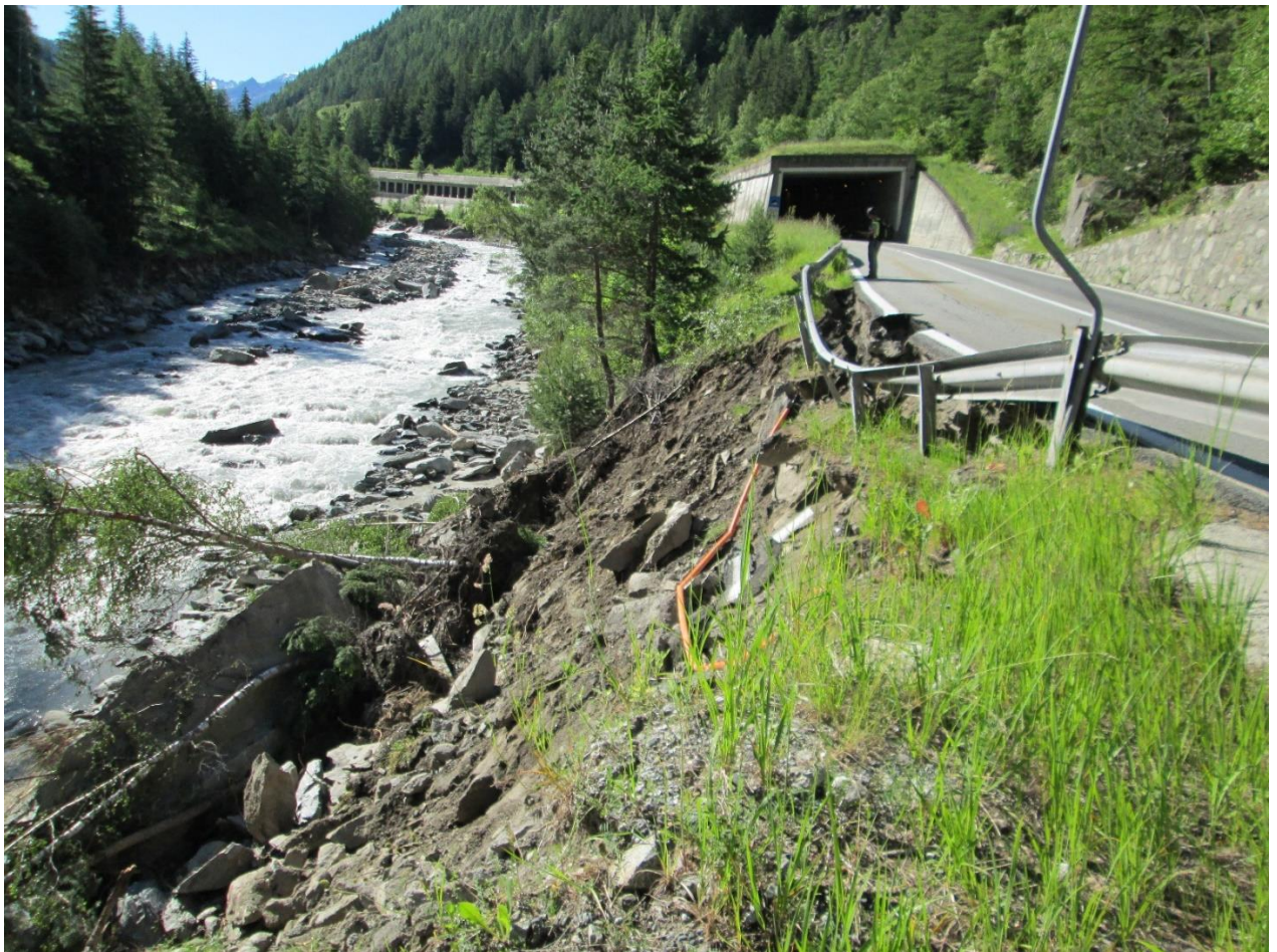
Cedimento di un tratto della carreggiata della S.R. 47 a seguito dell'erosione spondale del T. Grand-Eyvia (ID 3852)
