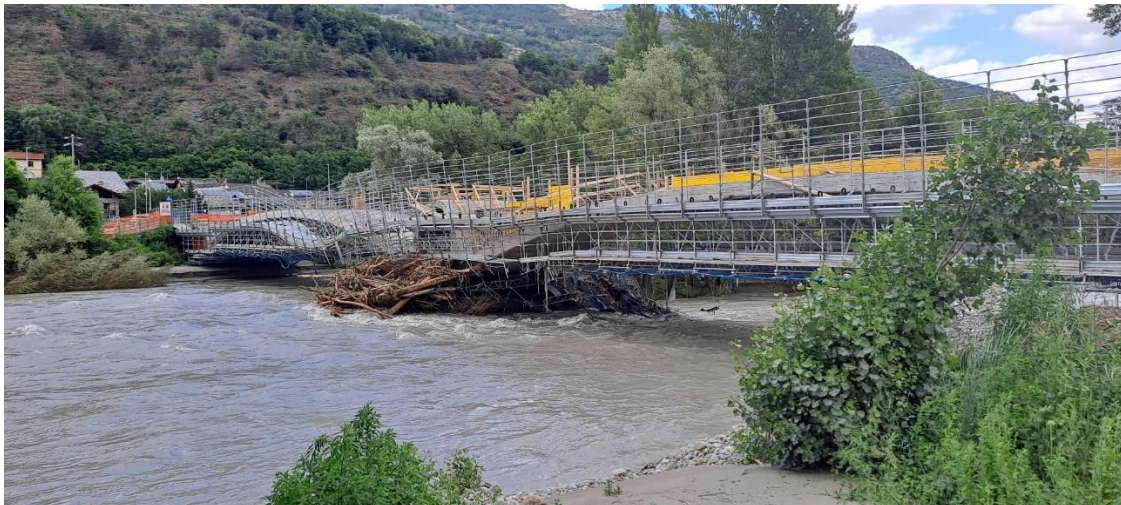
Crollo dei ponteggi installati sul ponte di collegamento tra la S.S.26 e la S.R. di Brissogne (ID 3788)
