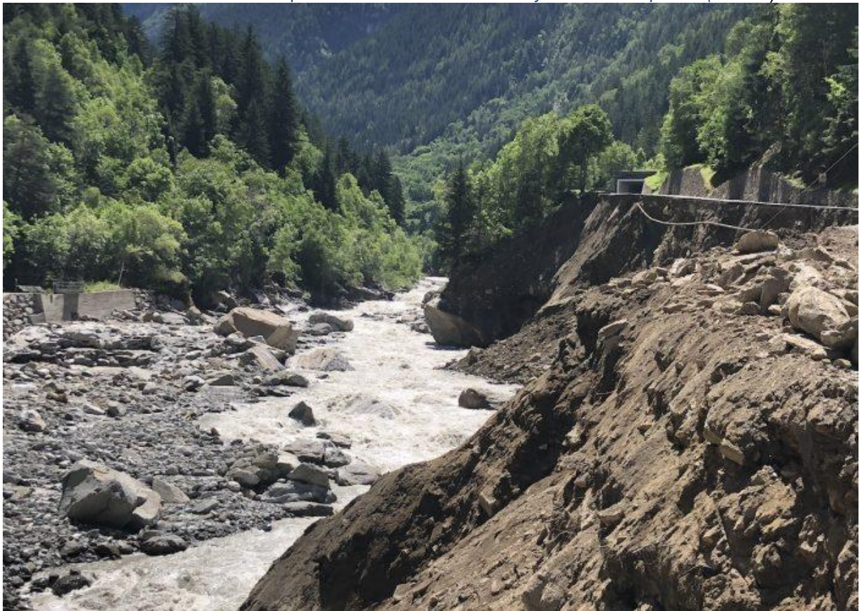
Vista di dettaglio. Erosione totale di un tratto della sponda sinistra idr. Del T. Grand-Eyvia. S.R. 47 asportata (ID 3722)
