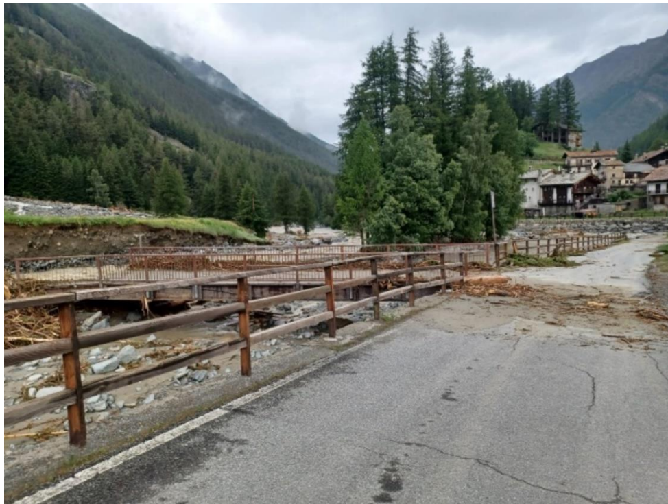
Vista del ponte danneggiato. (ID 3875)
