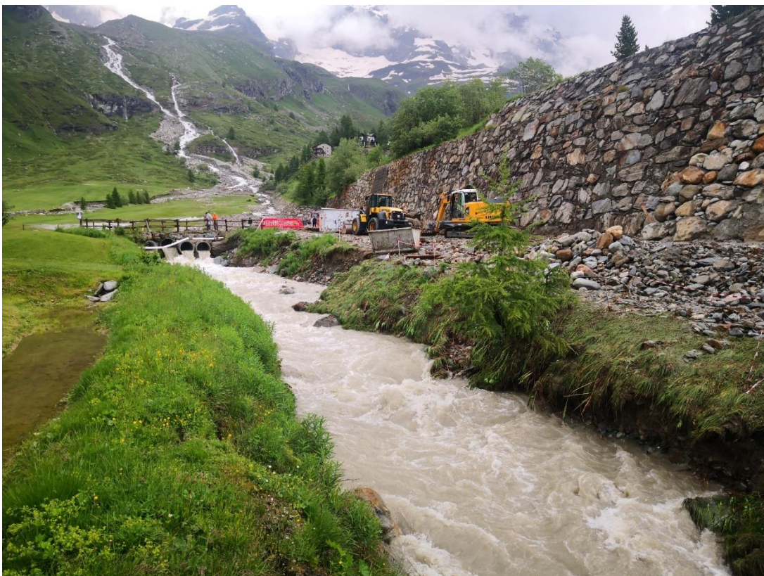
Danni alla strada dietro il rilevato paravalanghe, danni al ponte appena ricostruito sul T. Cherillon, danni gli argini del T. Cherillon, T. Cors e T. Maberger. (ID 3806)
