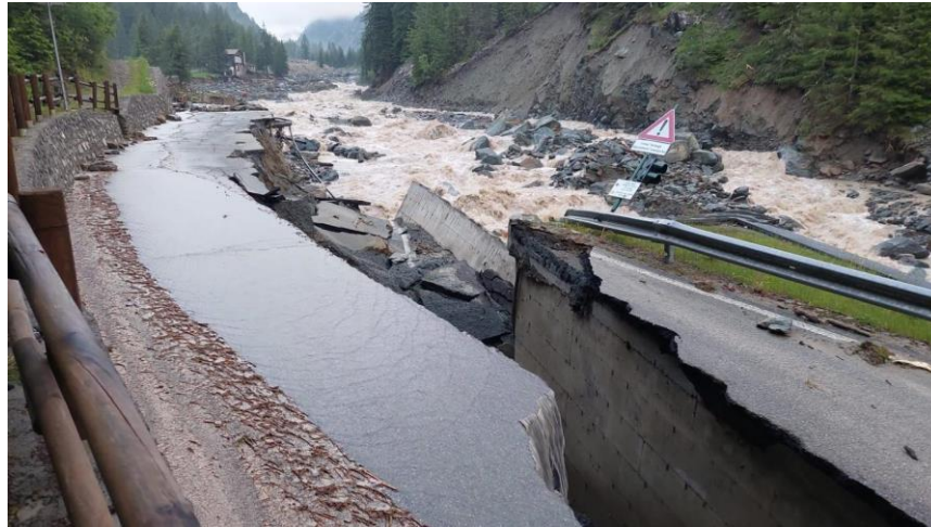
Tratto di strada distrutto e asportato.
