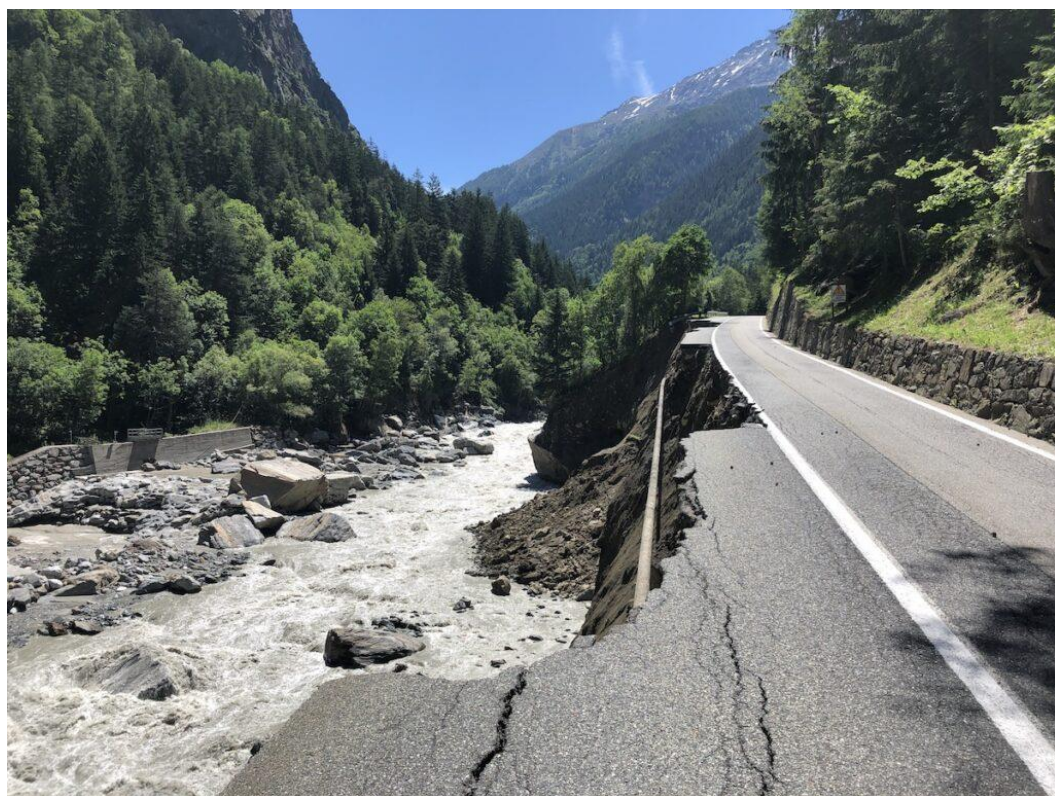
Cedimento di un tratto della S.R. 47 in località Chevril (ID 3722)
