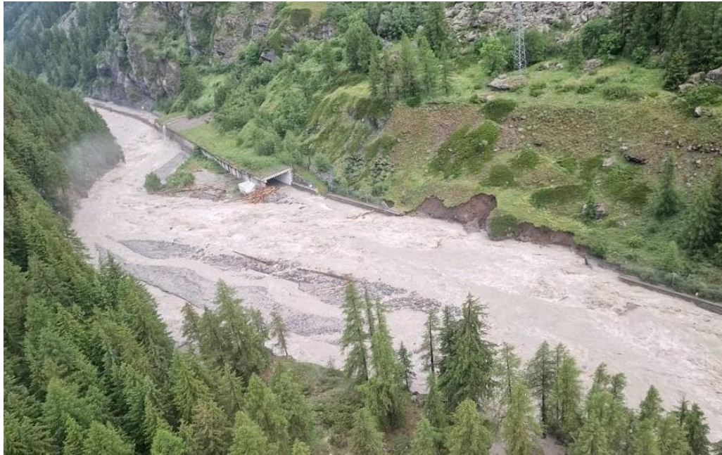
Altra vista del tratto di circa 200 m della S.R. 47 asportato (ID 3852)
