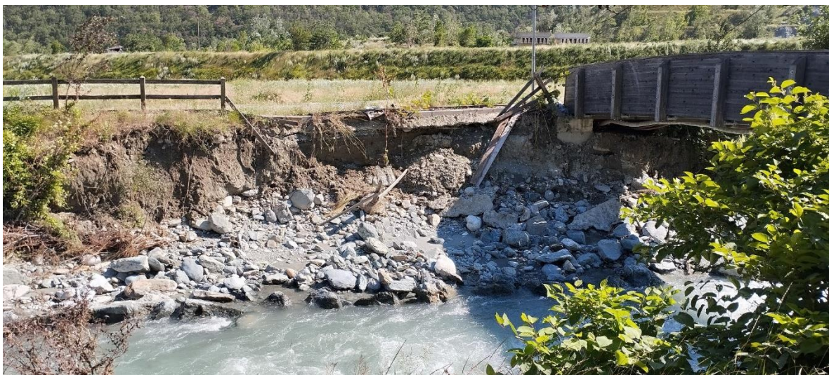
Erosione spondale spalla del ponte in legno che collega l'area ludica al prato di proprietà comunale (ID 3957)
