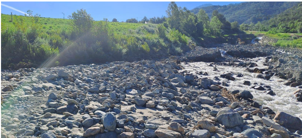
Operazioni di disalveo lungo il T. Saint-Marcel interessato da un fenomeno di trasporto di massa importante.
