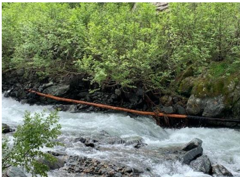
Erosione dell'argine con scopertura della tubazione comunale dell'acquedotto/fognatura in località Moos (ID 3884)
