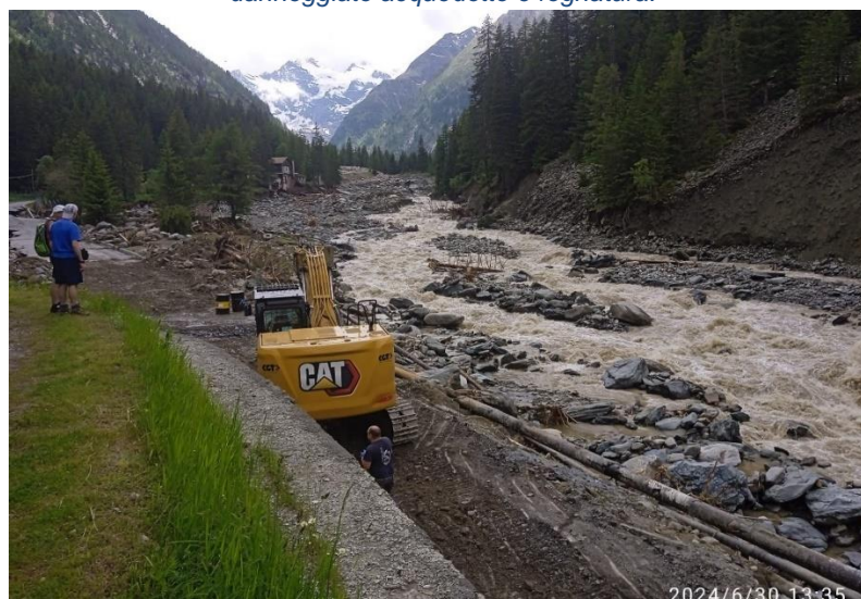
Altro tratto di strada completamente eroso.
